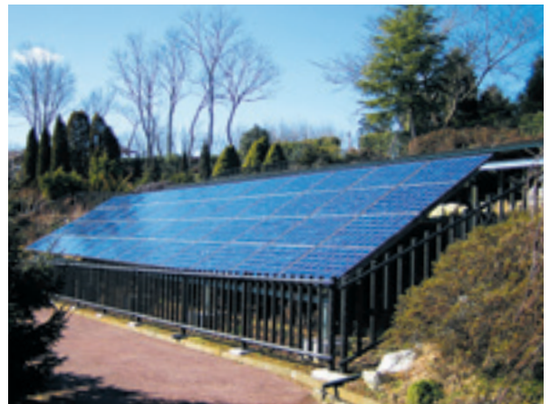
フラワーセンターの太陽光発電パネル
